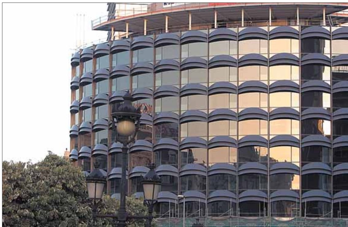
Façana de l'edifici Winterthur de la plaça Francesc Macià de Barcelona. / MARCEL·LI SAENZ
